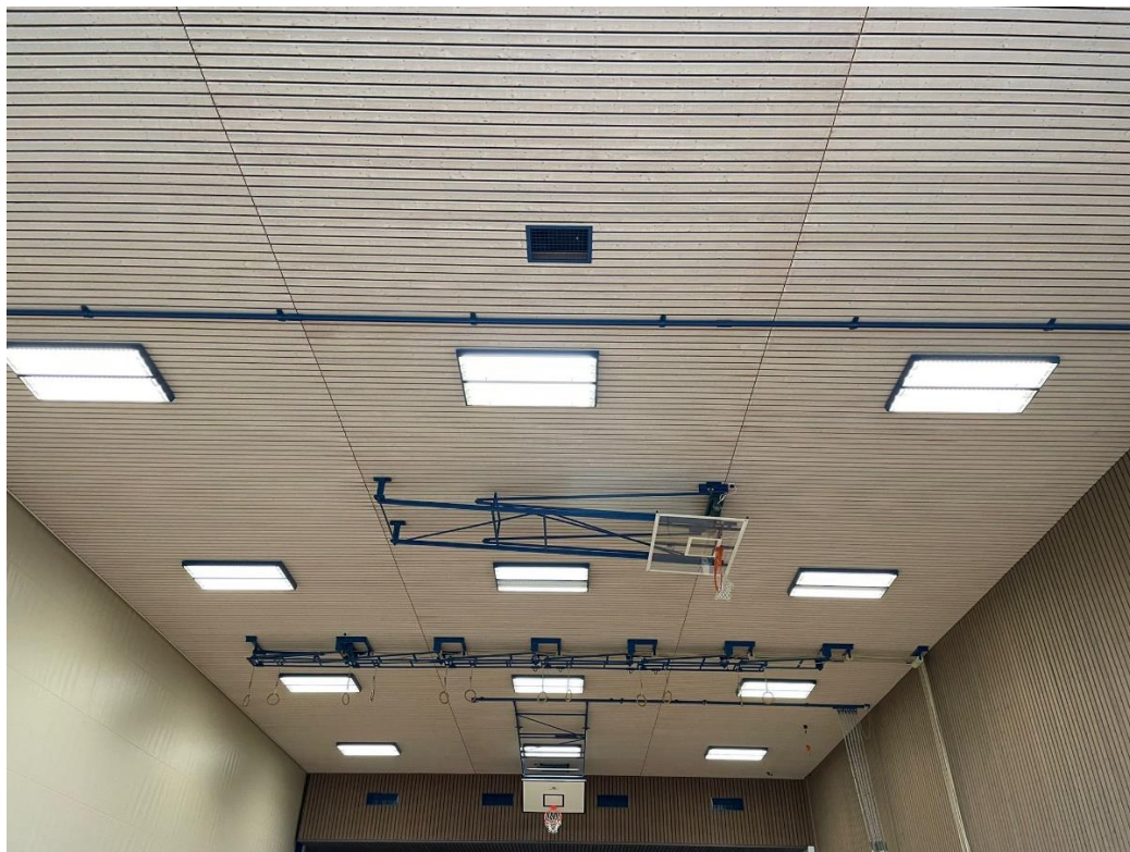
Bild: Beleuchtung Turnhalle Schmitteneggssli
