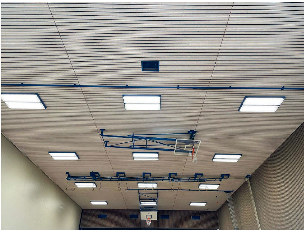
Bild: Beleuchtung Turnhalle Schmittenhässli
